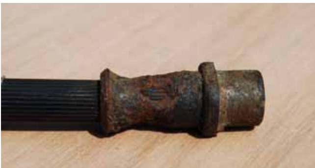
Wartel gedeeltelijk verdwenen als gevolg van corrosie.
